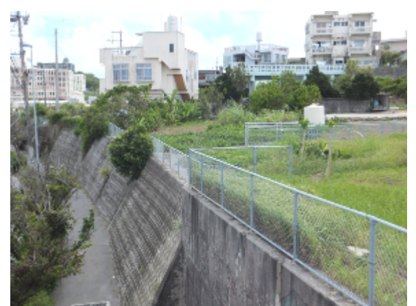
排水溝の出口付近
